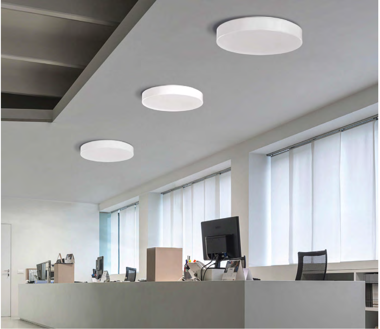
Ceiling lamps / Iluminación de techo
